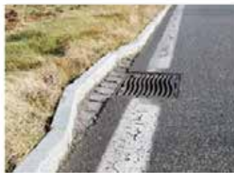
Abb. 6 Schachtdeckel mit schmaler Schlitzbreite und abgesetztem Randstein, sodass die Amphibien um den Rost herum laufen können.
