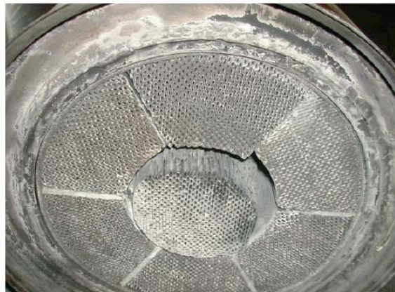
Versagen der Fugenverklebung infolge hoher Schwingungsbelastung
