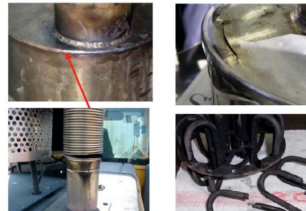
Folge hoher Schwingungsbelastung bei Schwachstellen der Konstruktion
