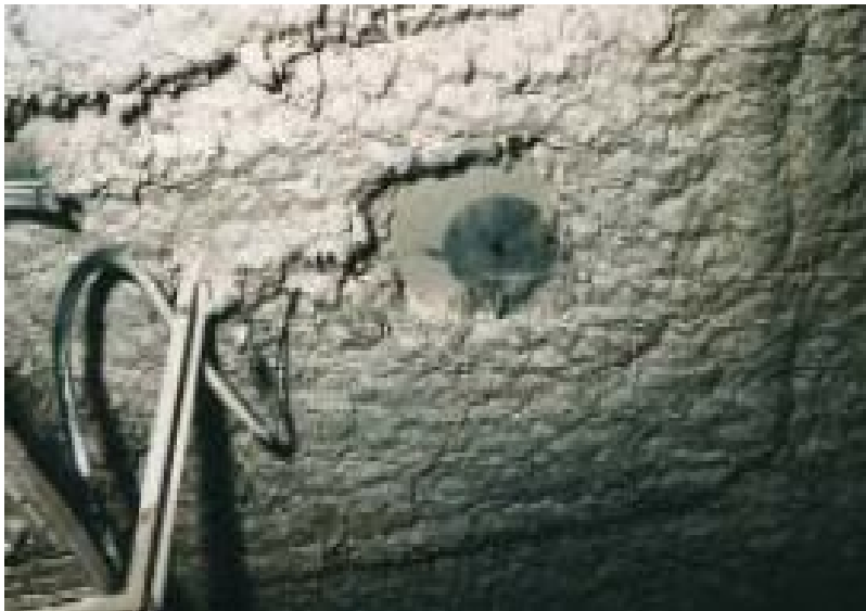
Flocage d'amiante, en sous face de dalle de parking
